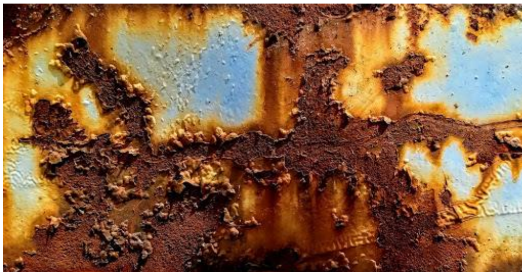
Figura 4.7 - Corrosão de uma chapa metálica.
