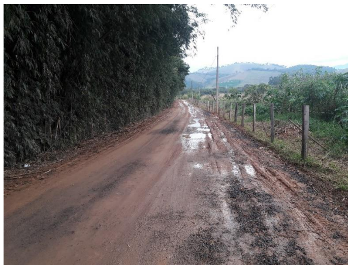
Figura 5 – Seção transversal sem o correto abaulamento (AUTOR,2018).
