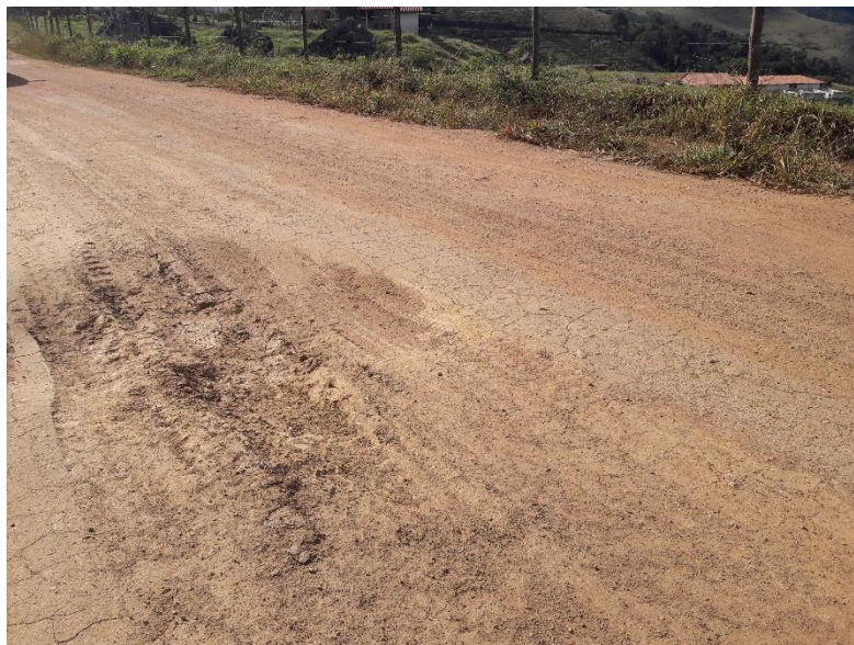
Figura 13 – Buraco localizado em uma estrada rural do município de Itanhandu-MG (AUTOR,2018).
