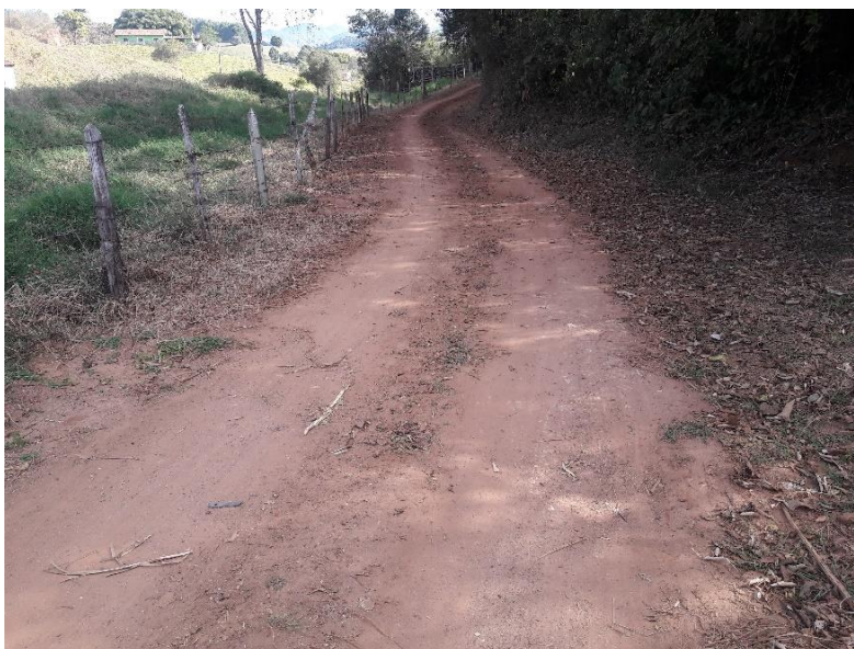
Figura 12 – Trilhas de rodas provocada pela passagem de veículos (AUTOR,2018).
