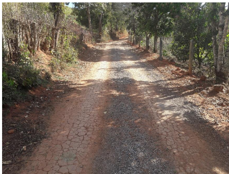
Figura 14 – Segregação de agregados em estrada vicinal (AUTOR,2018).
