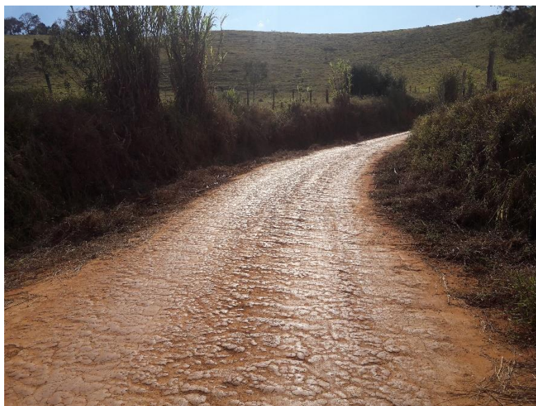
Figura 10 – Corrugações em uma estrada localizada no município de Itanhandu-MG (AUTOR,2018).
