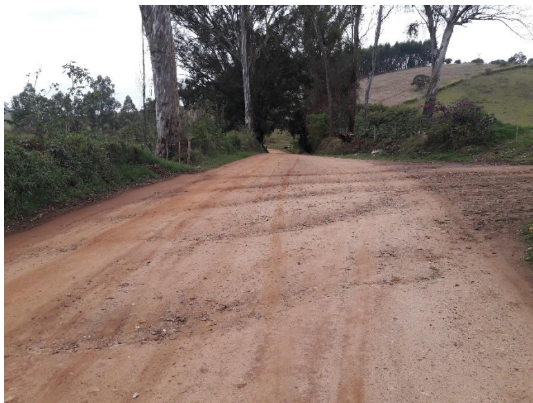
Figura 9 – Estrada sem dispositivos de drenagem adequados, provocando o escoamento da água pelo meio da via (AUTOR, 2018).
