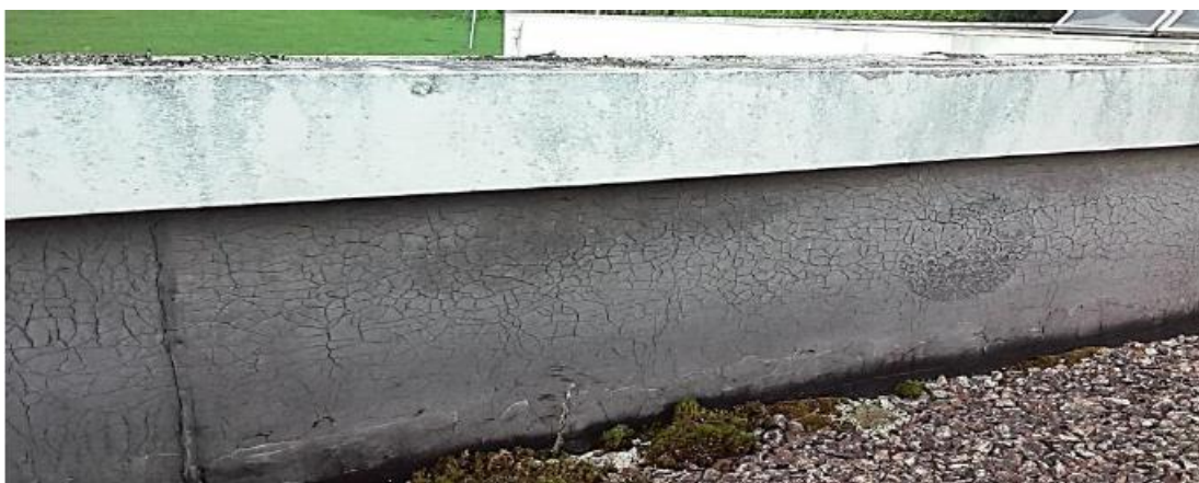
Figura 77 - Fissuração de manta betuminosa. Fonte: POÇA (2015)
