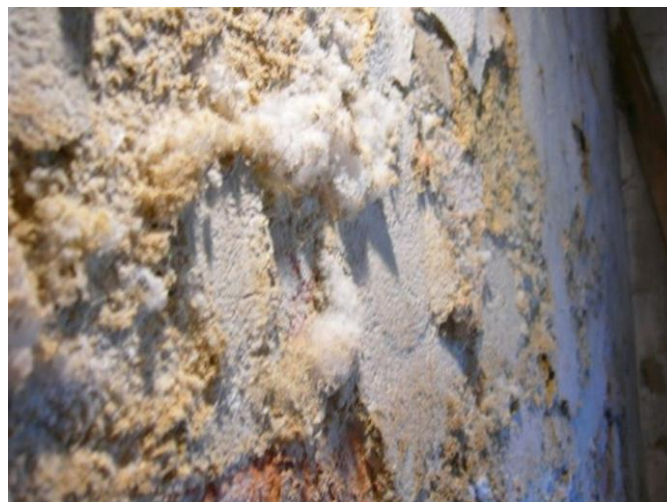
Figura 42 - Criptoflorescência em parede de alvenaria. Fonte: EVERY DRY WATERPROOFING (2014)
