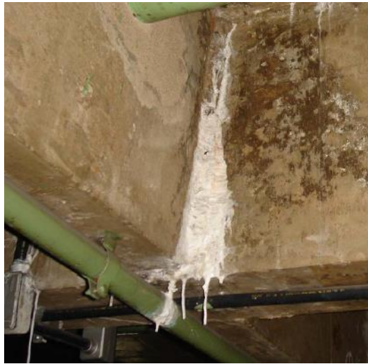
Figura 41 - Eflorescência decorada à umidade. Fonte: SOUZA (2008)
