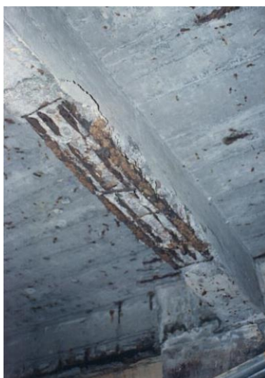
Figura 40 - Ferrugem em armadura de viga. Fonte: REFORMA FACIL (2010)
