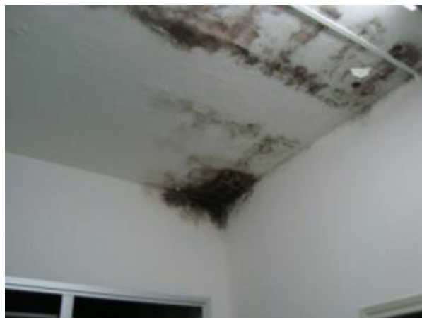
Figura 39 - Mancha de bolor em laje. Fonte: LEITE (2013)
