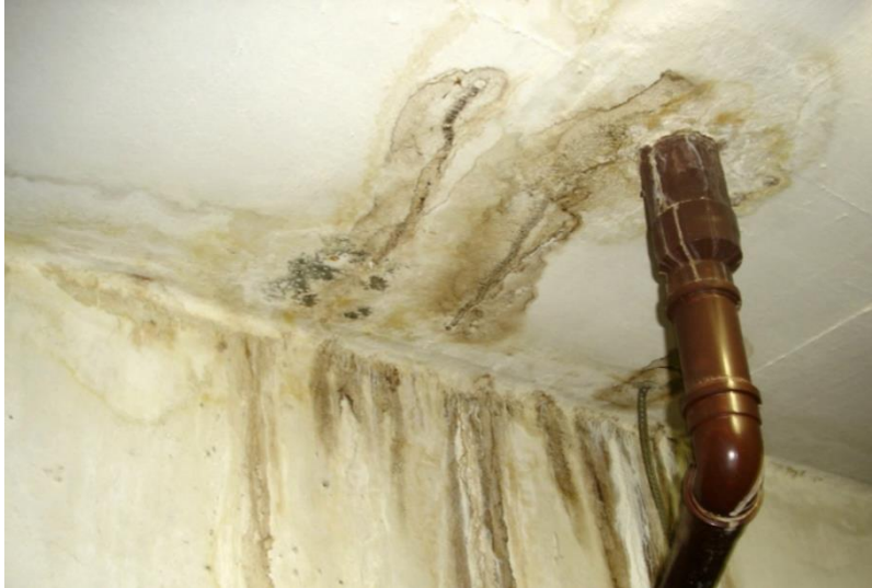
Figura 38 - Manchas decorrentes de umidade em laje. Fonte: PET CIVIL UFJF (2014)
