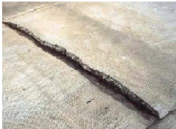
Figura 81 - Juntas de sobreposição descoladas. Fonte: QUARESMA (2015)
