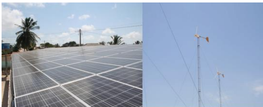
Figura 13 - Sistema Híbrido Fotovoltaico-Eólico instalado no Maranhão como parte do Programa Luz para Todos, 2011 [23]
