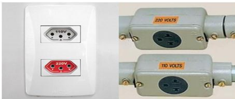
Figura 3.33: Identificação da tensão dos pontos de tomada de energia [39]
