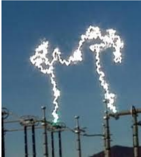
Figura 2.13: Arco elétrico formado na abertura de uma chave sob carga [12]
