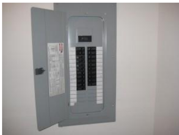
Figura 3.6: Quadro de distribuição com espelho [16]
