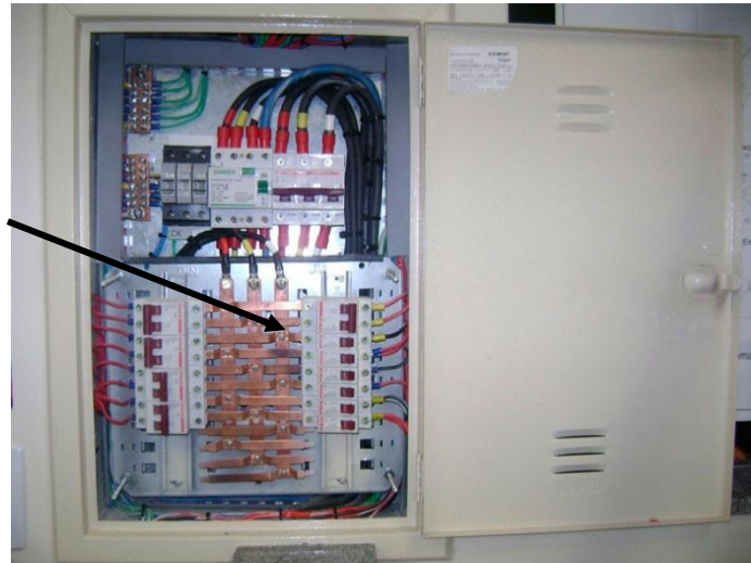
Figura 3.1: Barramento vivo de um quadro de distribuição [14]
