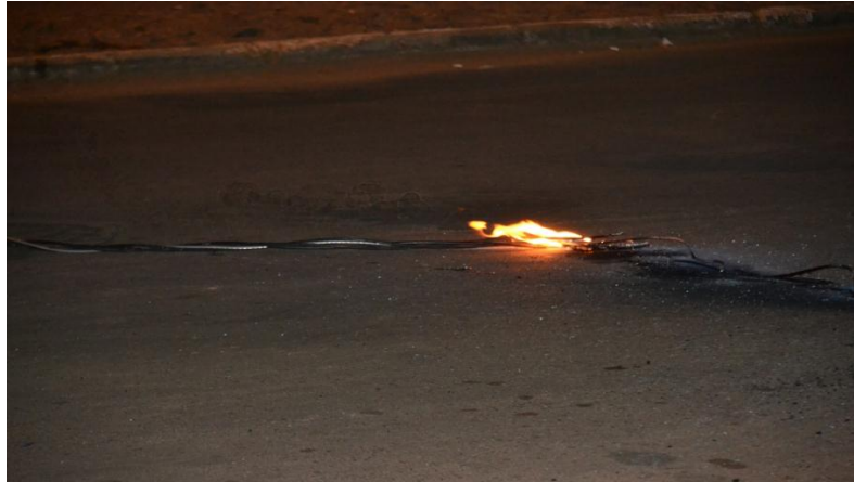
Figura 2.10: Cabo de alta tensão caído na rua [9]
