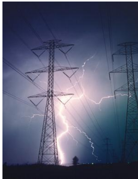
Figura 3.21: Incidência de descargas atmosféricas em linhas de alimentação [30]
