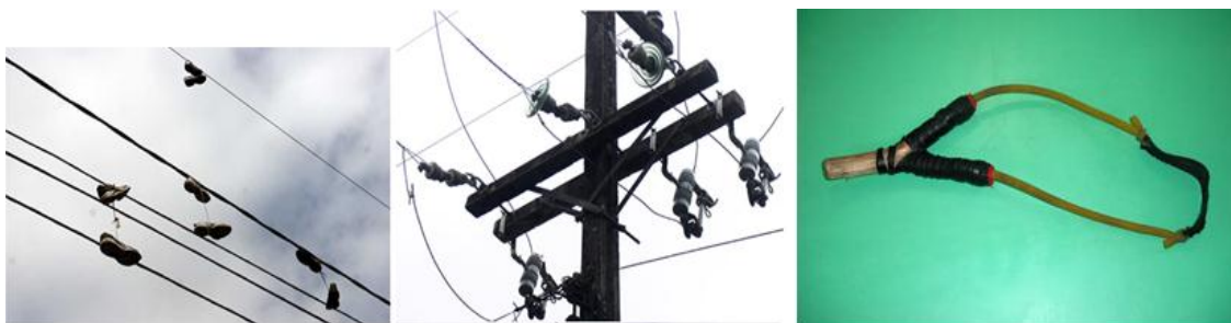
Figura 3.22: Ações de vandalismo na rede elétrica [31]
