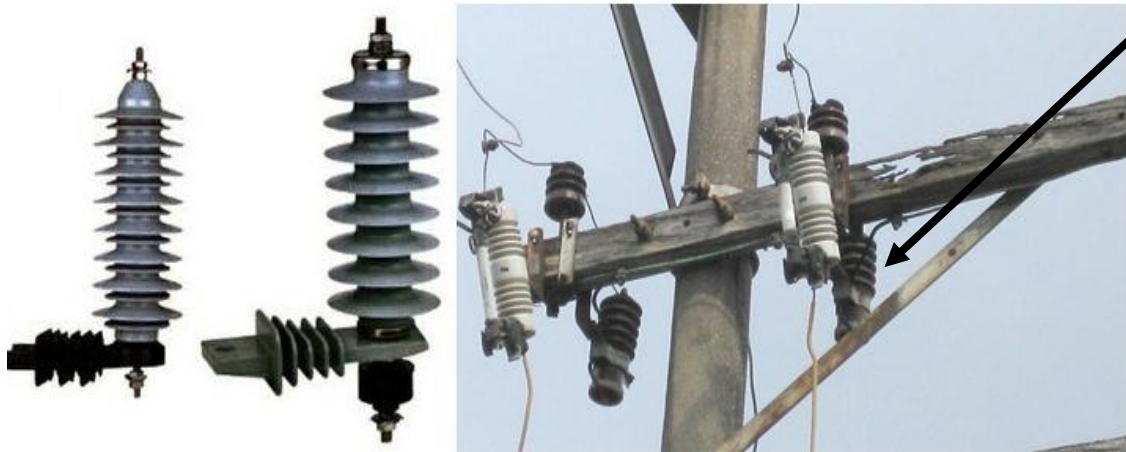
Figura 3.12: Para-raios de linhas de distribuição [22]
