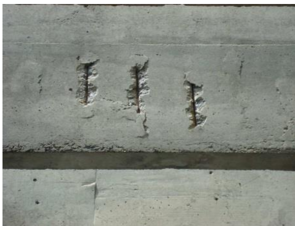
Figura 88 - Detalhe do deslaqueamento de concreto na viga. Fonte: SANTOS (2012)
