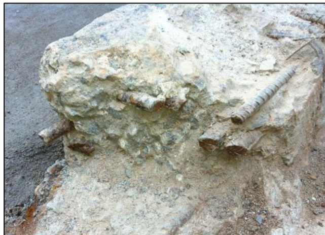
Figura 91 - Vista das armaduras que foram cortadas para a passagem de tubulação. Fonte: MORAIS et al. GROSSI (2013)
