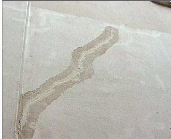
Figura 85 – Fissura selada. Fonte: PiniWeb (2008)
