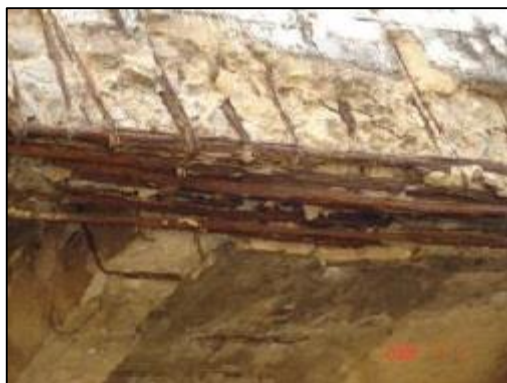
Figura 93 - Corrosão generalizada em estrutura. Fonte: VALVERDE (2013)
