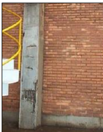
Figura 65 - Exemplo de pilar com armadura corroída. Fonte: GRANATO (2002)
