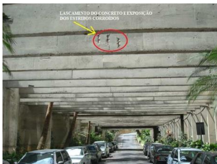
Figura 87 - Viga de concreto armado deteriorada. Fonte: SANTOS (2012)
