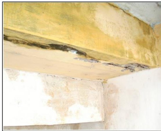
Figura 24 - Desagregação do concreto. Fonte: SILVA (2011)
