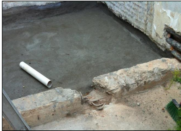
Figura 90 - Vista da seção de concreto removida da viga invertida. Fonte: MORAIS et al. GROSSI (2013)
