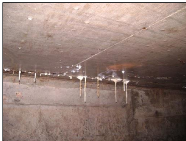
Figura 25 - Eflorescência. Fonte: SILVA (2011)
