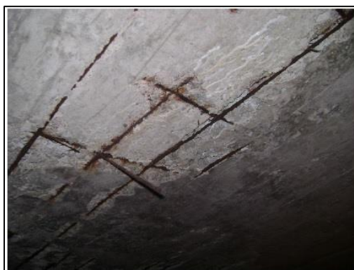
Figura 23 - Corrosão nas armaduras de uma laje. Fonte: SILVA (2011)
