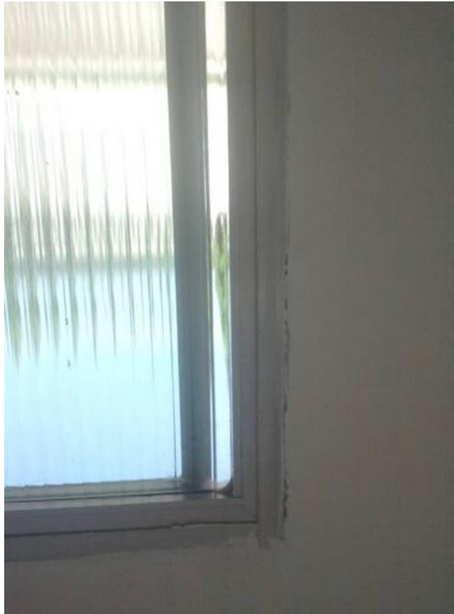
Figura 15 - Acabamento comprometido da extremidade da janela Fonte: O autor
