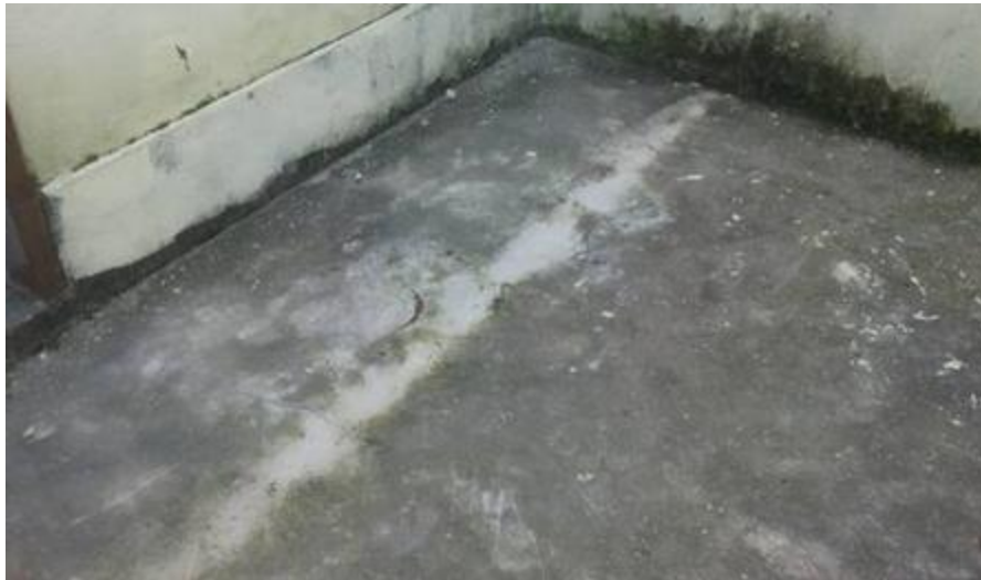
Figura 19 - Área externa sem caixa de gordura Fonte: O autor
