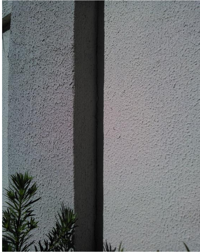
Figura 23 - Muro de frente sem amarração Fonte: O autor
