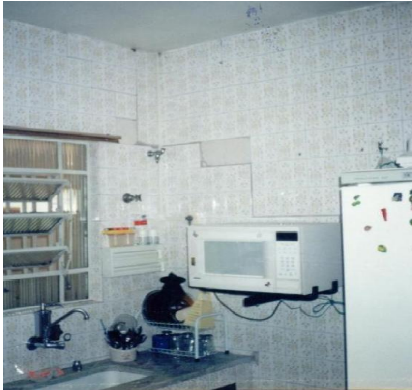
Figura 2 - Trincas e rachaduras causadas por recalque da fundação.
