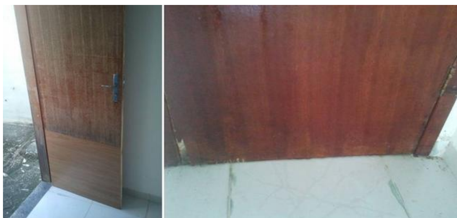
Figura 17 - Porta da área de serviço exposta à umidade Fonte: O autor
