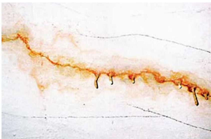
Figura 8. Água atinge o aço através das trincas
