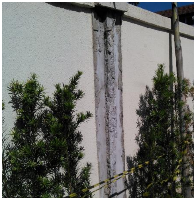
Figura 24 – alvenaria sem amarração Fonte: O autor
