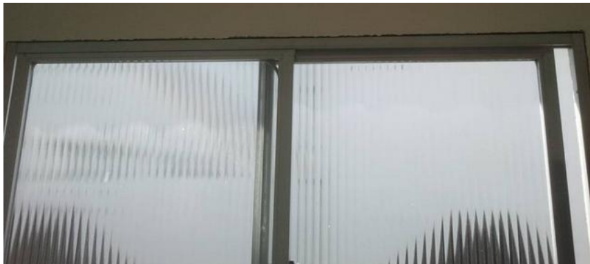
Figura 16 – Vão entre janela e parede sem vedação Fonte: O autor
