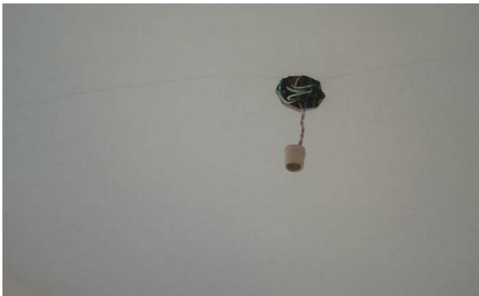
Figura 13 - Fissura no teto de gesso Fonte: O autor
