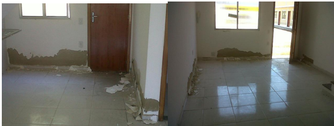
Figura 20 - Parede descascando na cozinha e sala
