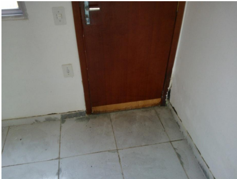
Figura 22 - Piso da cozinha manchado devido à umidade proveniente da fundação Fonte: O autor
