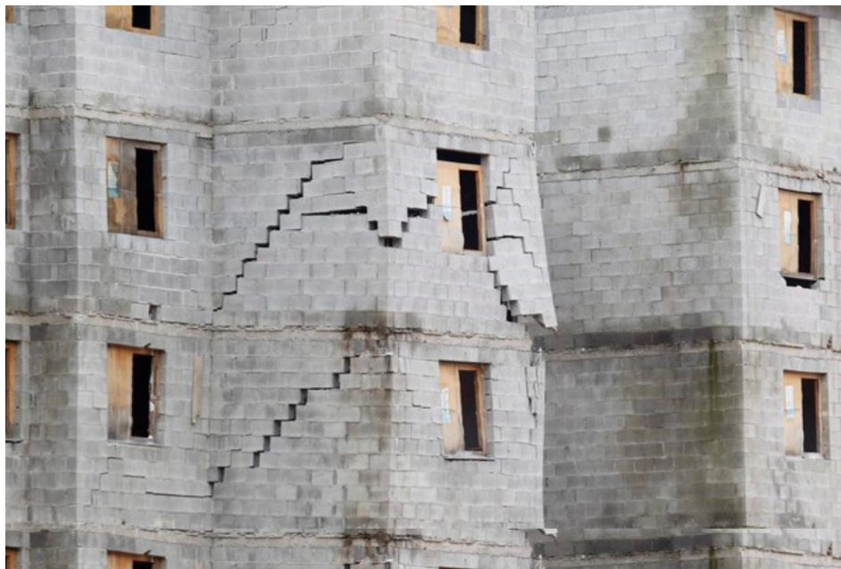
Figura 3 – Patologia causada pelo deslocamento do solo
