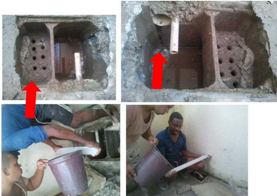
Figura 18 - Área externa sem caixa de gordura Fonte: O autor
