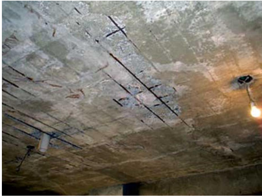
Figura 9. Armadura exposta devido à infiltração da água no concreto Fonte: < https://www.forumdaconstrucao.com.br/conteudo.php?a=17&Cod=1339 > Acesso em 04 de Abril de 2014
