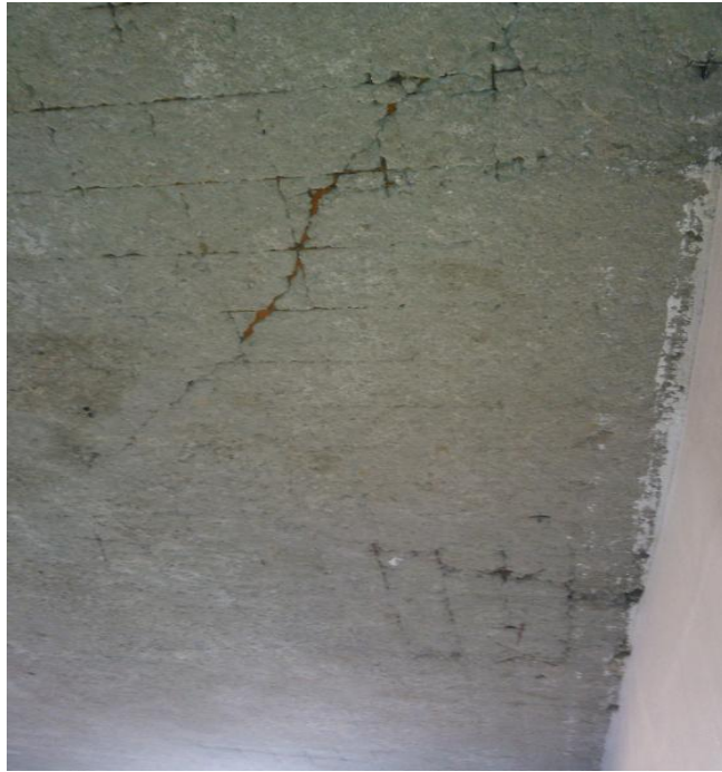
Figura 14 - Concreto da laje mal vibrado Fonte: O autor
