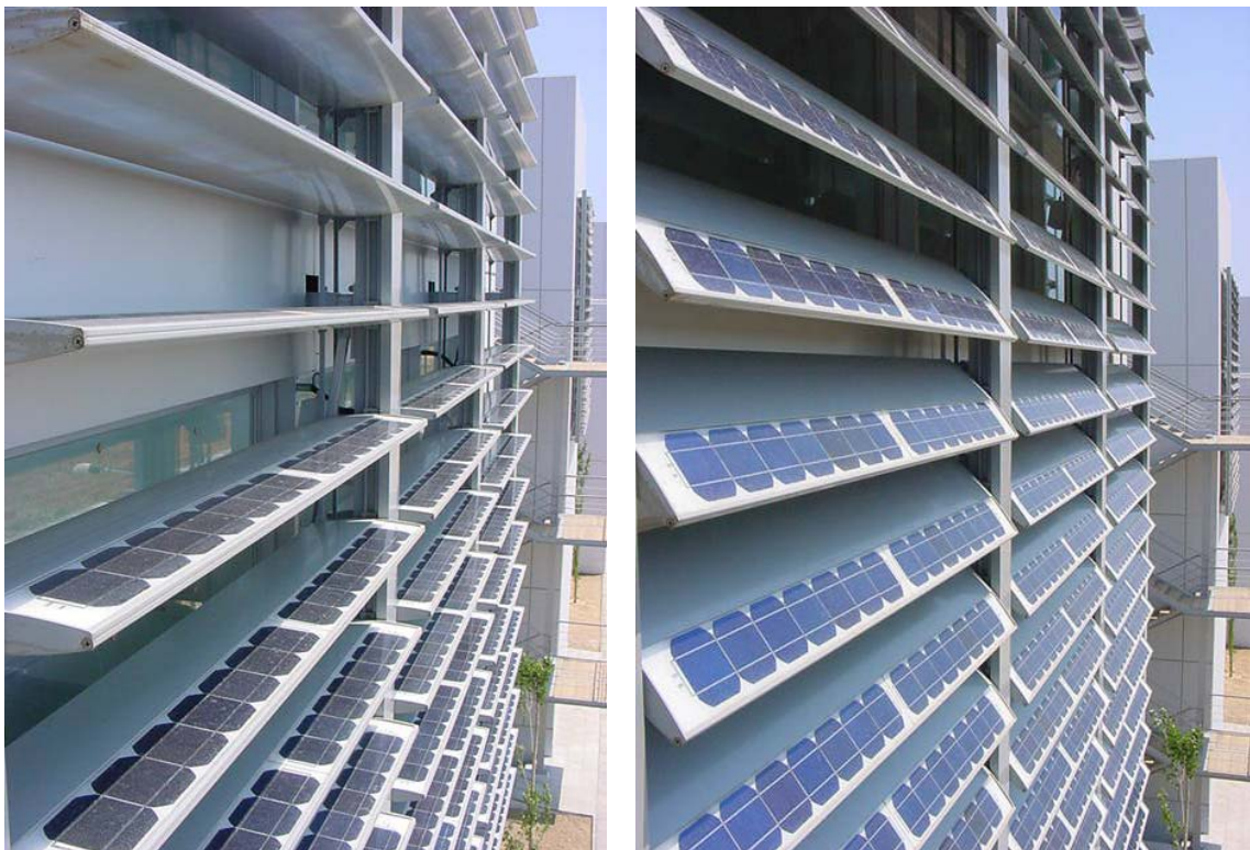
Foto 38: Detalle de las lamas fotovoltaicas orientables del centro para enfermos de Alzheimer, Madrid. Fuente: Guía integración fotovoltaica
