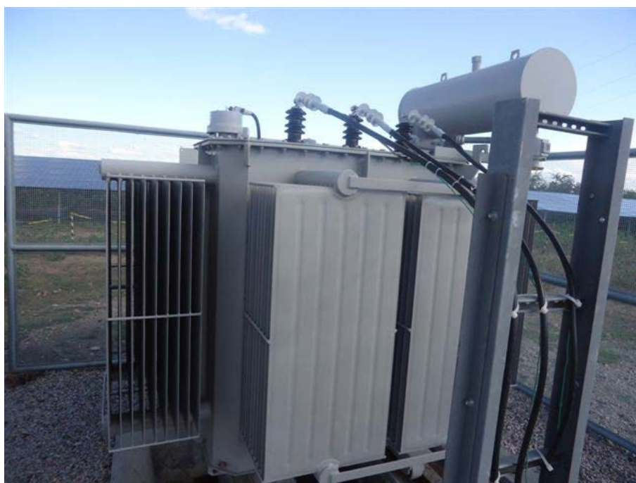
Figura 3.18 - Transformador Elevador ZILMER - 1250 kVA - 220 V / 13,8 kV
