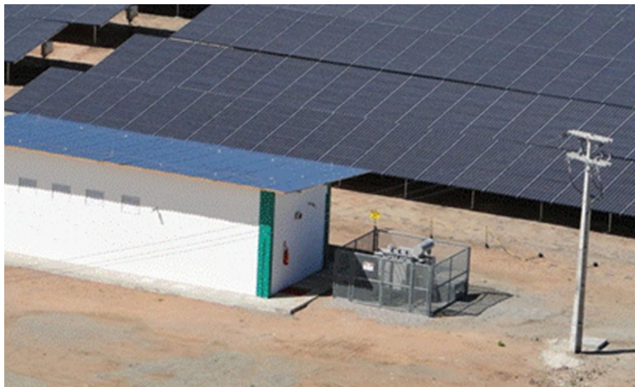
Figura 3.26 - Sala dos Inversores, Transformador Elevador e Poste para o escoamento da potência gerada
