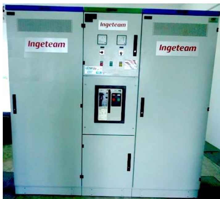
Figura 3.16 - Quadro Geral de Baixa Tensão (QGBT) instalado na usina
