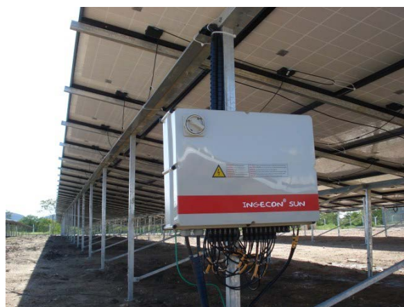
Figura 3.23 - Local de instalação das String Control Boxes
