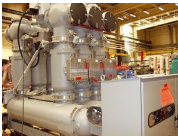
Figura 6 - Subestação de Manobra Isolada a SF 6 . [5]
