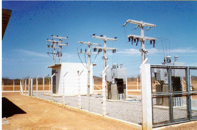
Figura 3 - Subestação de Média Tensão (13,8 kV).[3]
