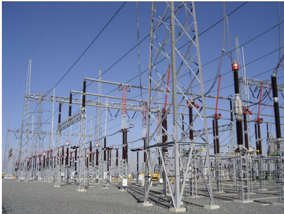
Figura 4 - Subestação de Alta Tensão. [4]
