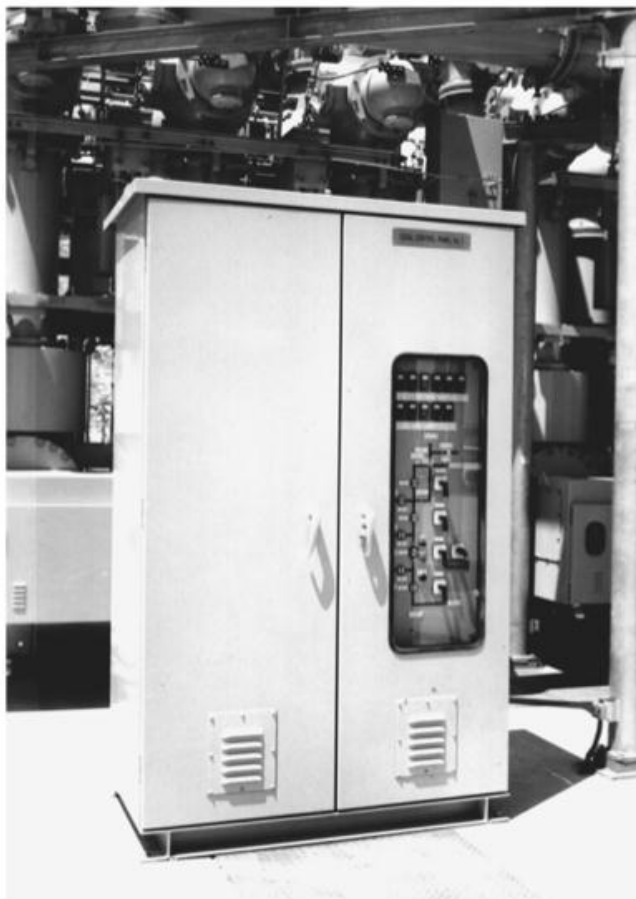
Figura 65 – Controle de Subestações a Gás [1]
