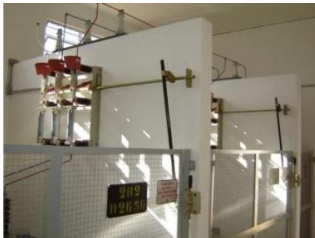
Figura 2 - Subestação de Baixa Tensão. [3]
