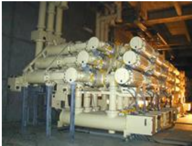
Figura 61 – Barramento de uma Subestação a Gás [21]
