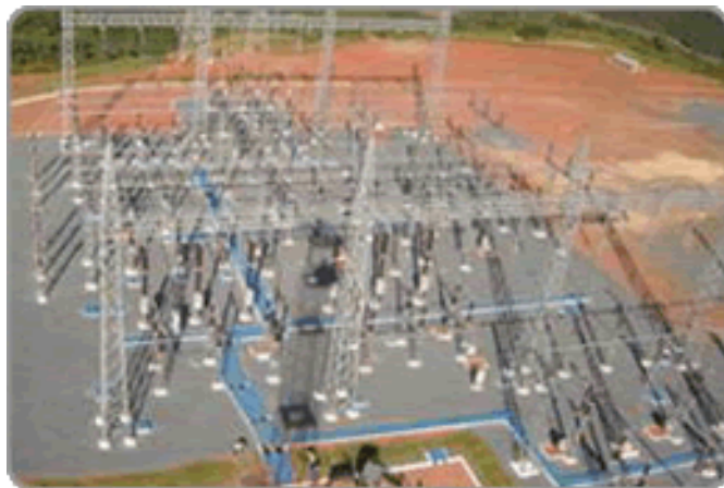
Figura 5 - Subestação de Extra-Alta Tensão (345 kV) de Irapé-MG .[4]
