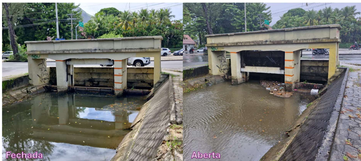
Figura 15 – Comporta do Rio dos Macacos localizada Rua General Garzón fechada na primeira imagem, e aberta na segunda imagem.
