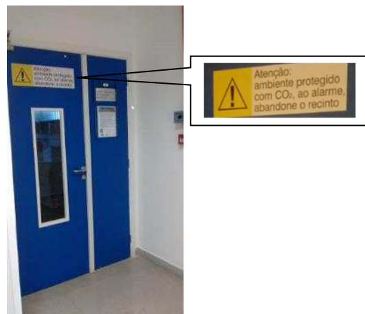
Figura 50 Aviso – proteção por sistema fixo CO 2 Fonte: Elaboração própria, 2018
