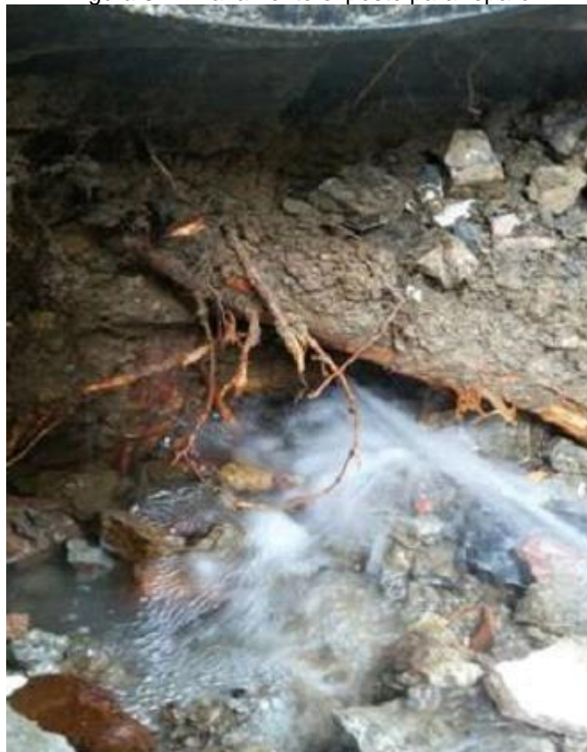
Figura 34 – Vazamento exposto para reparo
