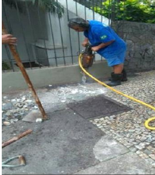
Figura 33 – Localização de vazamento oculto e reparo
