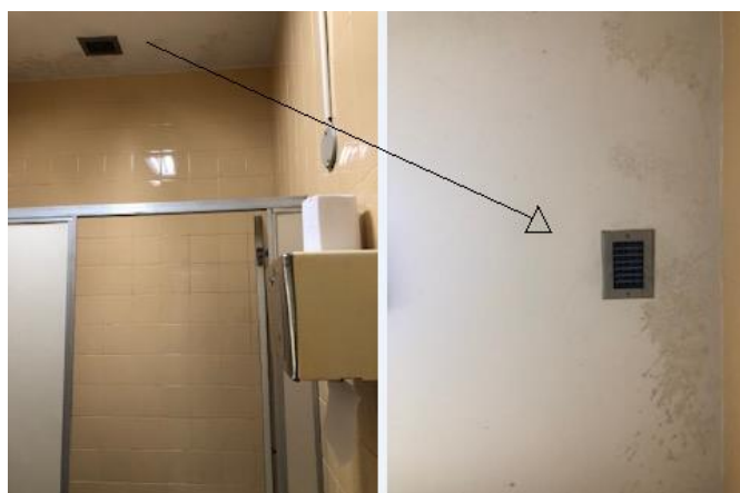
Figura 11 - Ambiente sem janela com exaustor inoperante
